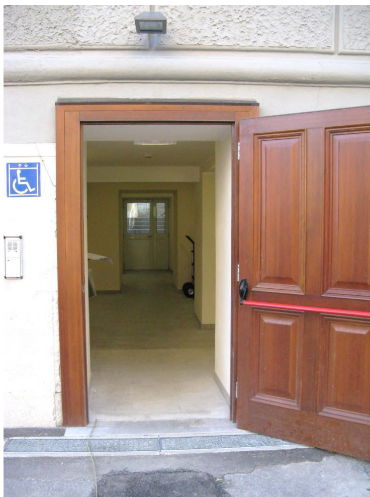
Porta con maniglione antipanico e altezza inferiore a 2,10 m di 3 cm a rigore fuori norma.
