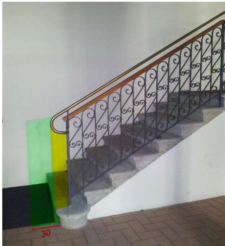
Manca il passamano sul lato muro.
